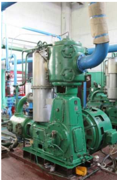
Рис. 1. Компрессор ВП 20/8 МУ4, установленный в компрессорной АО «ПЗСП»
