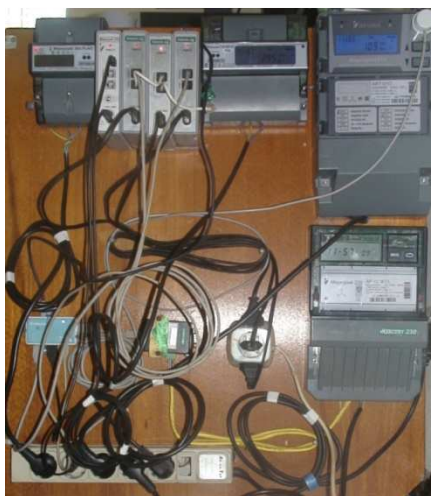
Рис. 2. Испытательный стенд для работы с АСКУЭ
