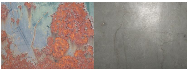
Рис. 1. Изображения коррозии и металла соответственно
